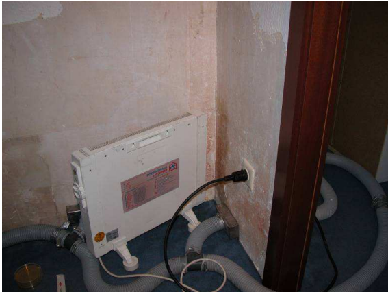
(Bild 2) Sockelbereich im Flur zum Kinderzimmereingang
